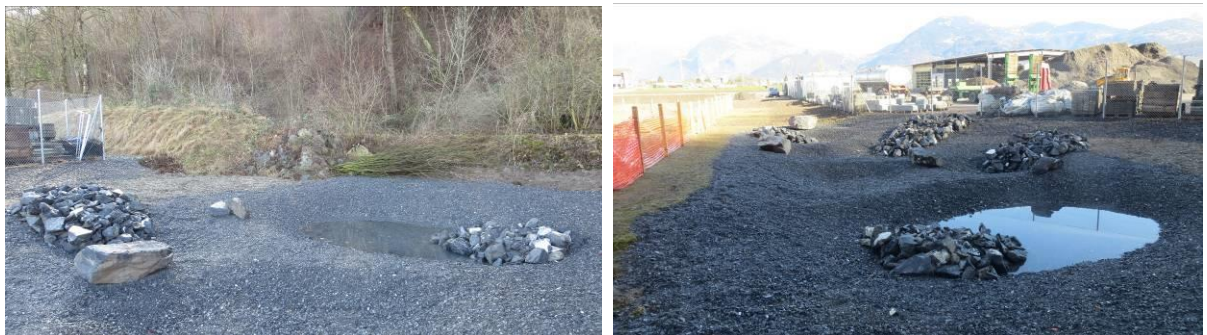
Figure 19. Extension réalisée en février 2017. Mares en cours de remplissage par l'eau de pluie.
